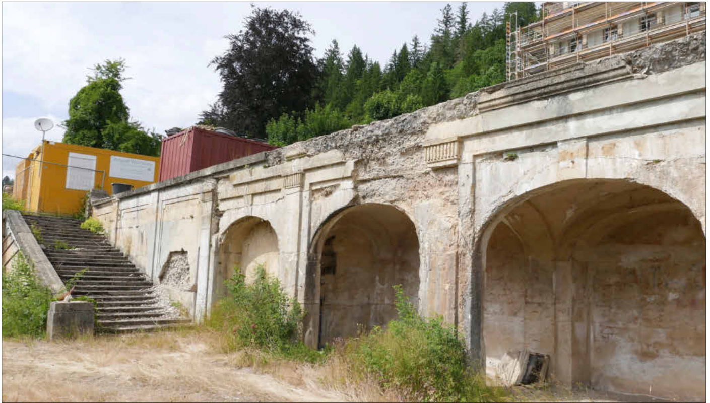
Der Sanagarten in St. Blasien ist sanierungsbedürftig. In den nächsten beiden Jahren stehen Betonwerksteinarbeiten an.
